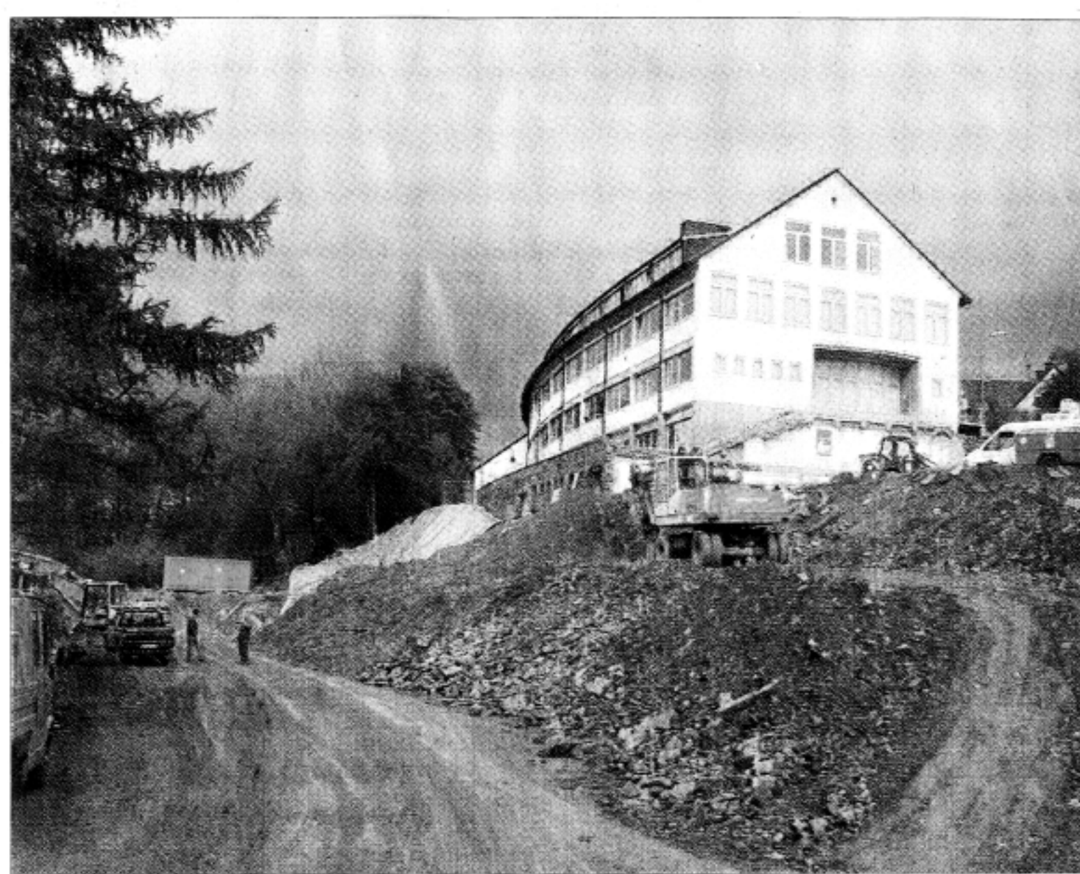
Die Baustelle des Berufskollegs Hepel: Hier ist in den letzten drei Wochen viel Erde für den Anbau von 15 Klassenräumen bewegt worden. Auch die alte Treppe zum Haupteingang wurde abgerissen. (Foto: Decker)
